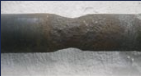
Erosionskorrosion an Welle einer Schmutzwasserpumpe
